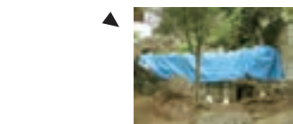
本館玄関脇の大谷石の擁壁が崩落。崩落部分は竹垣を組んで、再生しました。
