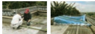
屋根瓦が一部剥落したため、修理工事までの間ビニールシートで応急措置。
